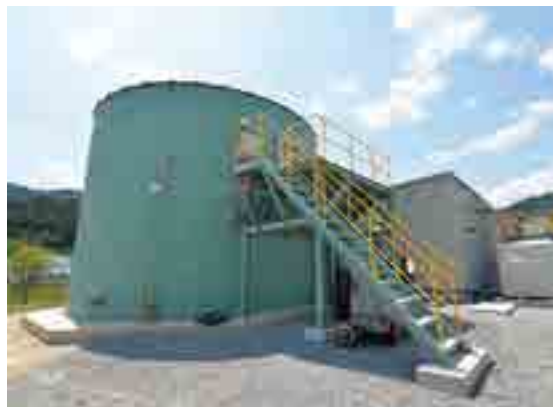
メタン発酵プラントシステム(発酵槽)
