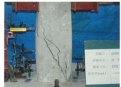
6 セン断破壊試験状況 負側 1/50 第1回目 せん断破壊位置は、注入位置ではなくオリジナルコンクリート。
