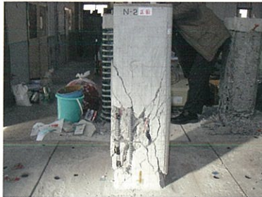
1 セン断破壊試験後、補修前状況 柱状供試体(製作時 N-02)
